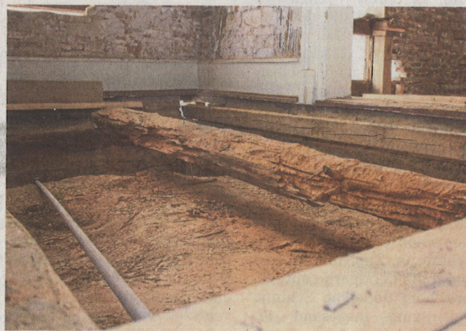
Selbst Laien können mittlerweile erkennen, wie sanierungsbedürftig viele Teile der Tragkonstruktion am Konventsgebäude sind.
